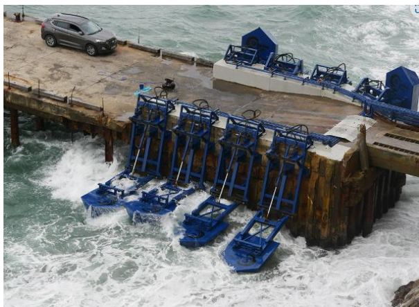
100kWの波力発電
