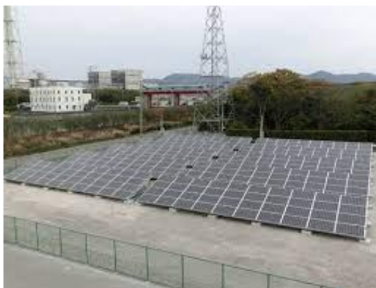
100kWの太陽光発電
